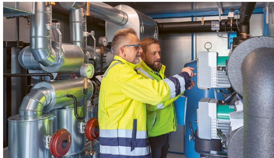
Die Fernwärmestation von Innen. Foto: Julian Salinas.
