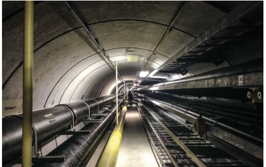
Im Leitungstunnel 17 Meter unter dem Rhein ...
