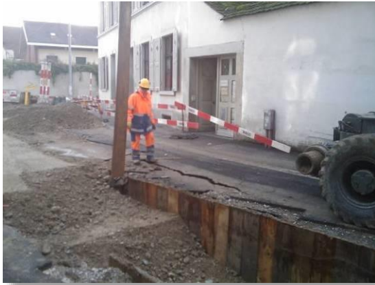
Werkleitungsräben: Spriessung zu spät gezogen
