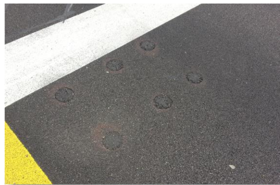
6 Bohrkernbeisammen, anstatt auf 200 m verteilt
