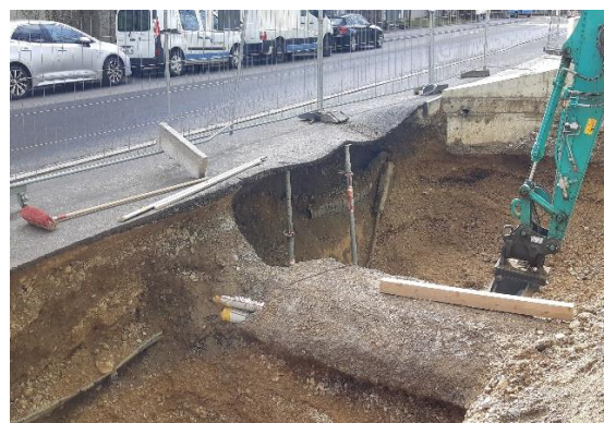
Fehlende Spriessung (2.5 m Tiefe) Baugrube
