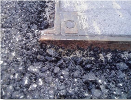
Tragschicht zu hoch gebaut
