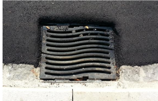
Zu tief eingebauter Einlaufrost
