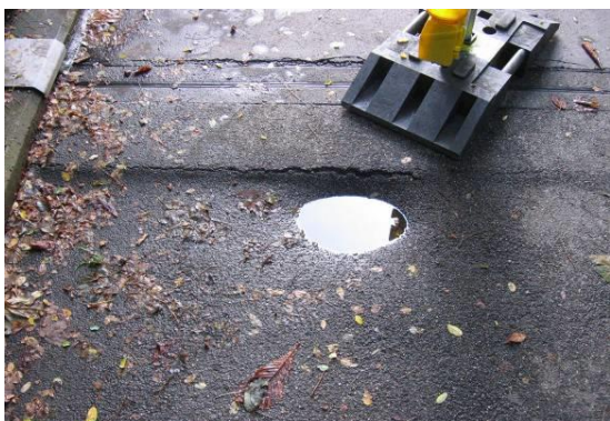
Senkung (ungenügende Verdichtung)
