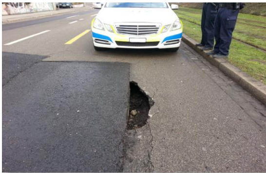
Einbruch bei Bauprovisorium
