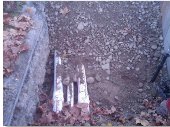
Rohrumhüllung ungenügend (zu grosse Steine)
