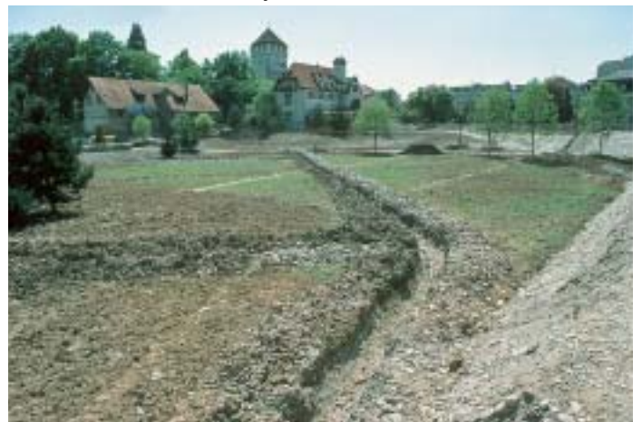
Abb. 19 Vorbereitungsarbeiten für die Gestaltung der zentralen Wiese am 7. Juni 1989. Foto: A. Coray
