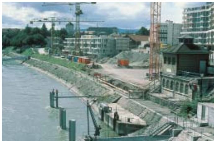
Abb. 17 Das Gelände wird für den Saalbau und das Restaurant «Rhypark» vorbereitet, dahinter ist ein fast fertiggestellter Wohnblock sichtbar: Das Rheinbord St. Johann am 27. August 1986 von der Dreirosenbrücke aus gesehen. Foto: A. Coray
