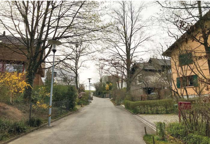
Der Wyhlenweg vor der Umgestaltung: öffentliche, aber privat genutzte Areale gehen ins Strassenareal über, Randabschlüsse fehlen, Strassenentwässerung fehlt, Kandelaber stehen auf der Strasse, Hangsicherung (im Hintergrund) fehlt. Foto: Daniel Schoop
