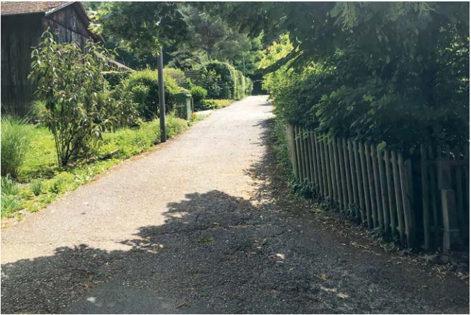
Der Linsbergweg vor der Umgestaltung: stark zersetzter, ausgemagerter Asphalt, Randabschlüsse und Strassenentwässerung fehlen. Foto: zVg Jauslin Stebler
