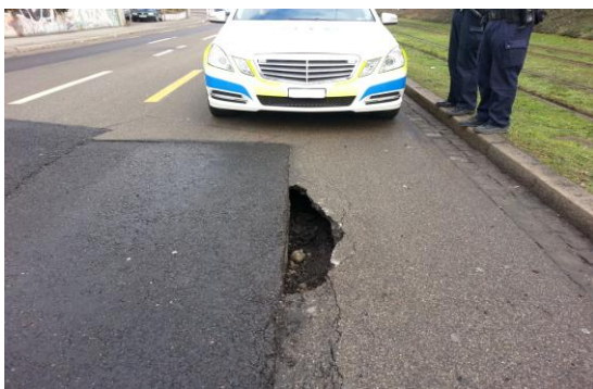
Einbruch bei Bauprovisorium
