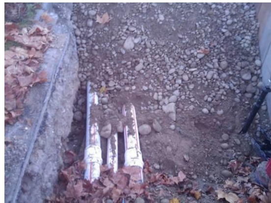
Rohrumhüllung ungenügend (zu grosse Steine)
