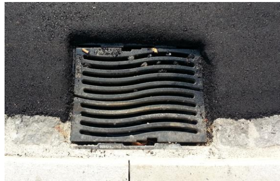
Zu tief eingebauter Einlaufrost
