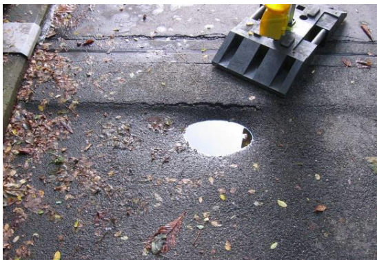
Senkung (ungenügende Verdichtung)
