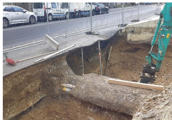
Fehlende Spriessung (2.5 m Tiefe) Baugrube
