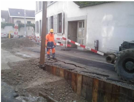
Werkleitungsgräben: Spriessung zu spät gezogen
