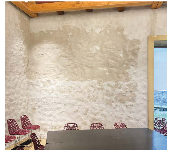
Feuchtigkeitsschäden Baslerhofscheune, Foto: Daniel Schmitt
