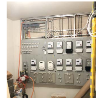
Elektrotabelleau, Foto: Andres Linder, externer Bauverwalter
