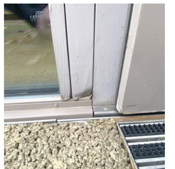
Schaden an Fensterrahmen, Foto: Daniel Schmitt
