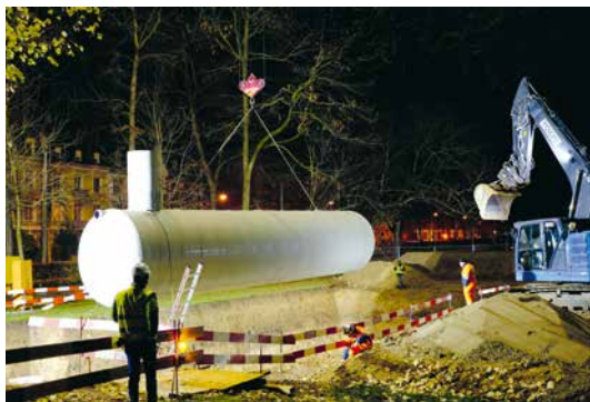
Retentionstank mit 100m 3 Fassungsvermögen. Foto: Berchtold + Tosoni AG
