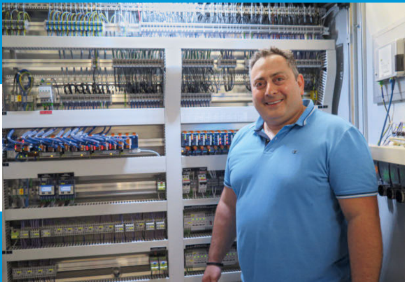
Christos Georgiadis vor dem Schaltschrank der Gebäudeautomation für Lüftungs- und Heizungsanlagen im Neubau des Schulhauses Schoren
