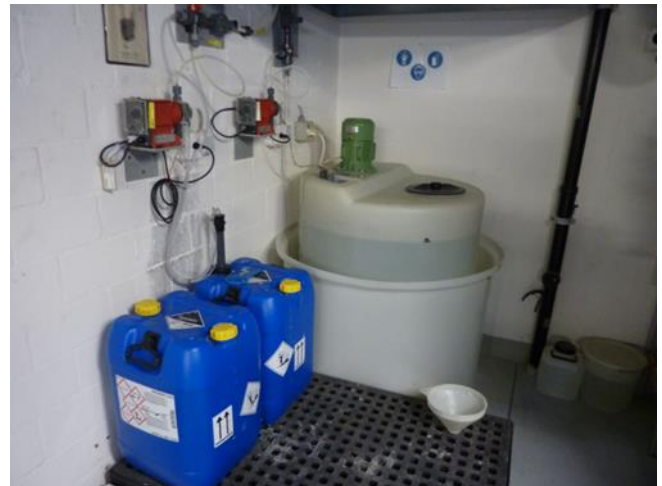
Dosierstation für Schwimmbadchemikalien
