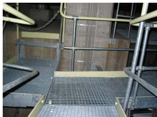
Nachleuchtanstrich Geländer und Fussleisten
