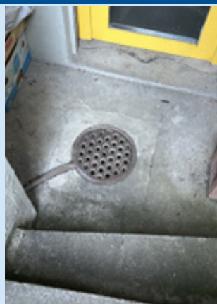
Dolen auf Privatgelände, z.B. in Kellerabgängen oder Dachabläufen.
