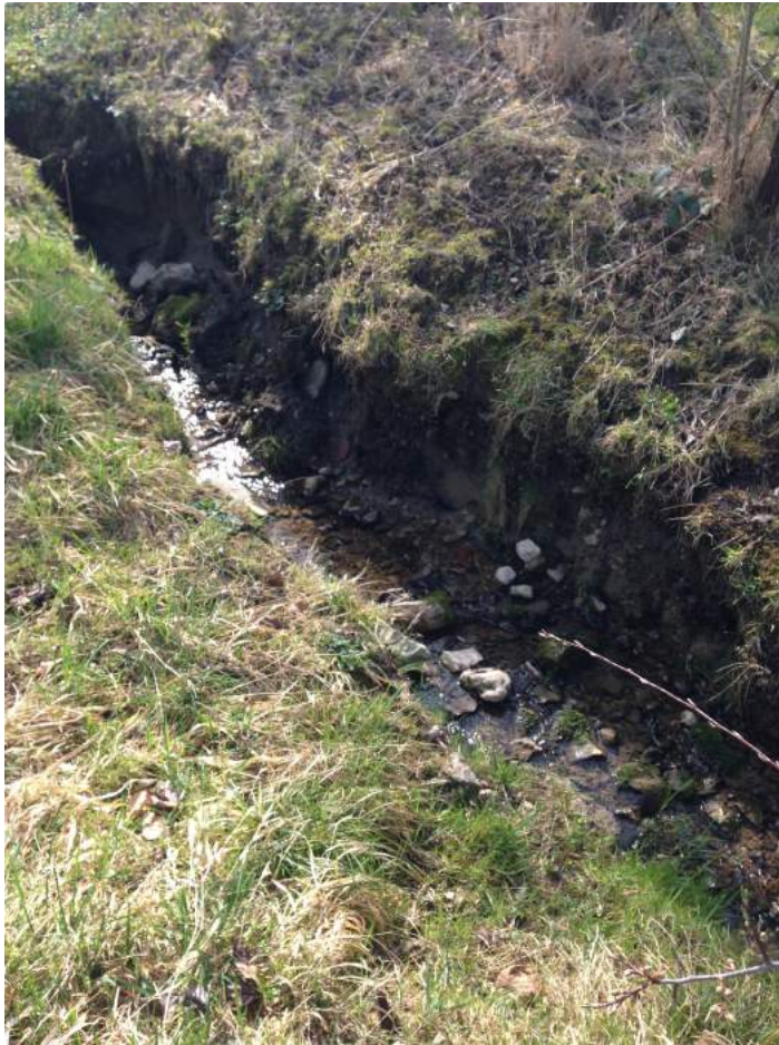
Fig. 5: Die obere Strecke des Bettingerbachs (BE2) liegt in einer Weide unterhalb des Bettinger Schwimmbads. Der kleine Bach hat sich oberflächlich in seine Umgebung eingetieft.
