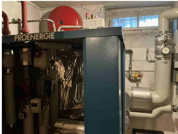
Heizung Gas / Warmwasser - Kombigerät
