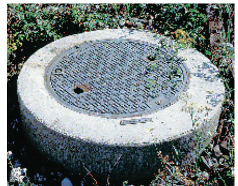
Der Kontrollschacht ist verschraubt und gut sichtbar angeschrieben.
