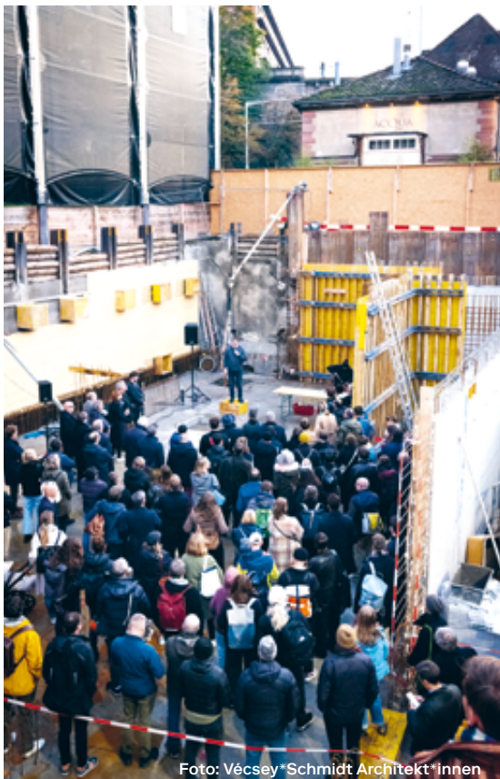
11-2022 Grundsteinlegung für die Neue Kuppel Basel im Nachtigallenwäldeli: Der Bau der Bandproberäume wird mit einem Investitionskostenbeitrag von 1,7 Millionen Franken von Basel-Stadt unterstützt.
