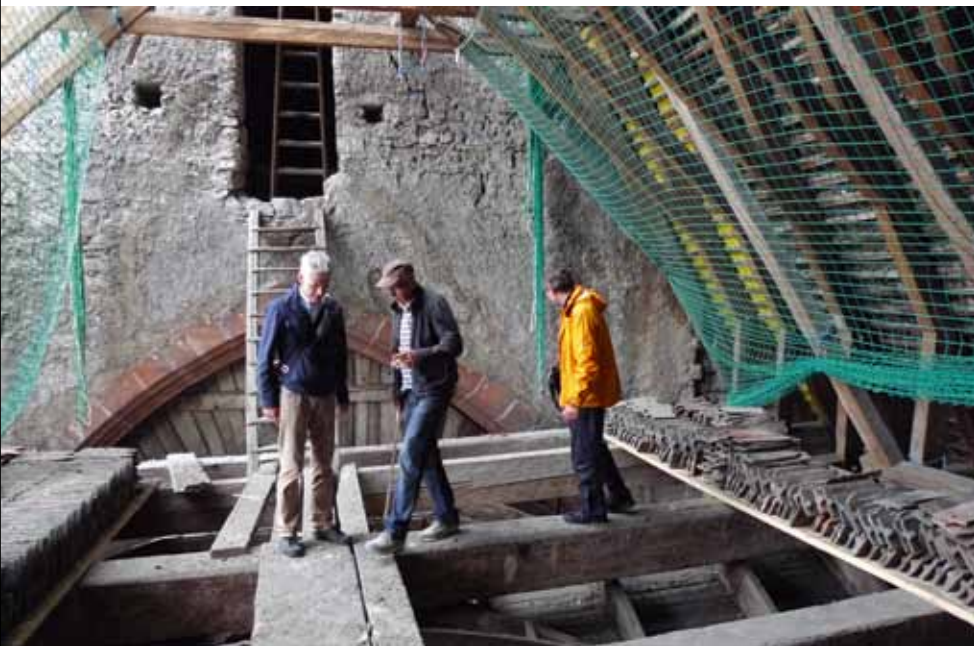
Der Dachstuhl über dem Kirchenschiff stammt von 1363. Vor Ort diskutieren Münsterbaumeister Andreas Hindemann und die Bauforscher Bernard Jaggi und Hans Ritzmann von der Kantonalen Denkmalpflege die überraschenden Befunde zur Baugeschichte der ehemaligen Klosterkirche. Foto Juli 2012.
