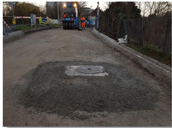
Unzulässige Schachtumhüllung mit Beton
