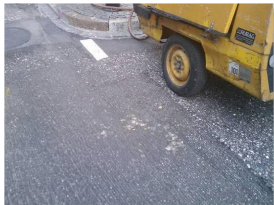
Tragschicht zu dünn eingebaut (nach Fräsarbeiten von 3 cm erkannt)
