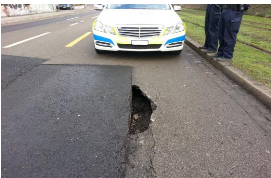
Einbruch bei Bauprovisorium
