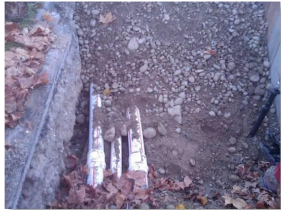
Rohrumhüllung ungenügend (zu grosse Steine)
