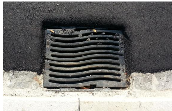
Zu tief eingebauter Einlaufrost
