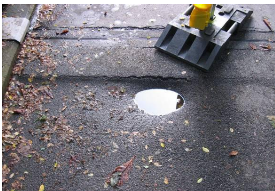
Senkung (ungenügende Verdichtung)
