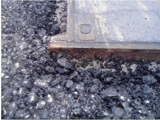
Tragschicht zu hoch gebaut
