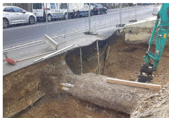
Fehlende Spriessung (2.5 m Tiefe) Baugrube
