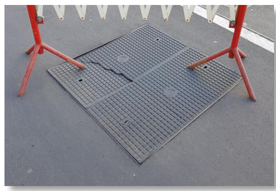
Falsche Lastklasse der Abdeckung in einer Fahrbahn
