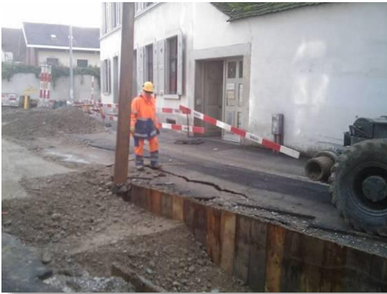
Werkleitungsgräben: Spriessung zu spät gezogen
