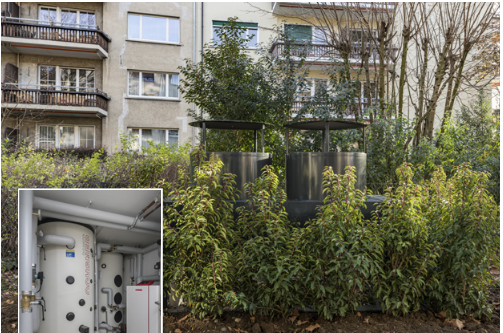
Von Grün umrahmter Tischverdampfer im Garten, Heizungskeller mit Heiz- und Warmwasserspeicher und Innenteil der Wärmepumpe.
