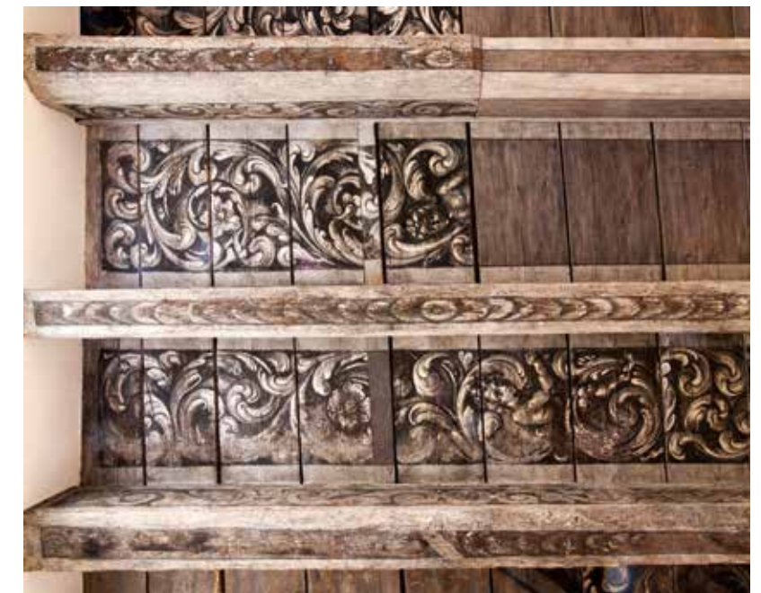
Petersgasse 38, Andlauerhof: Dekorationsmalerei aus dem 17. Jahrhundert an einer wesentlich älteren Balkendecke. Wenn wertvolle Ausbau- und Ausstattungselemente erst im Zug einer Bauausführung entdeckt werden, bedeutet deren Bewahrung stets einen unvorhergesehenen und oft erheblichen Kostenfaktor. Dann sind das Engagement der Bauherrschaft und die Verfügbarkeit von Zuschussmitteln die einzige Rettung.
