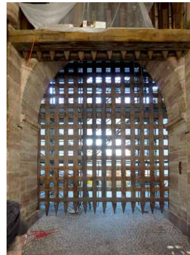
Die Zimmermannskonstruktionen wurden repariert (Balustrade des oberen Umgangs), ergänzt (Dachwerk), gereinigt und konserviert (Torflügel und -sperrn). Im Bild das herabgelassene Fallgatter und – am oberen Bildrand im Vordergrund – die Fallbalkenanlage.
