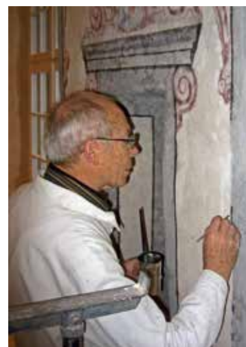
Restaurator aus Passion: Paul Denfeld bei der Arbeit im Haus zum Roten Zuber, Blumenrain 26. Foto 2005.
