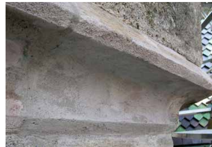
Links oben: Abgewitterte Steinpartien sind 1932–1934 mit unterschiedlich gefärbten Mörteln ergänzt worden, was zusammen mit Scheinfugen aus hellem Kalkmörtel ein intaktes Bild ergab und zusätzlichen Verlust von mittelalterlichem Originalmaterial (durch Steinersatz) vermied. Dieses Konzept wurde bei den aktuellen Massnahmen beibehalten (oben), wobei das Augenmerk neben der Formergänzung auch der Wiederherstellung der ursprünglichen Wasserführung mittels Tropfkanten galt (unten).
