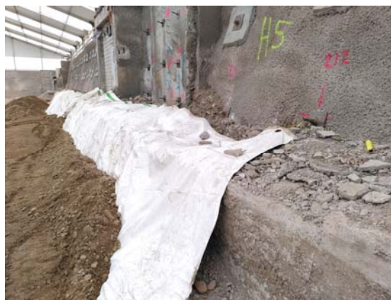
Abb. 5: Folie auf Restbelastung mit Kiessand
