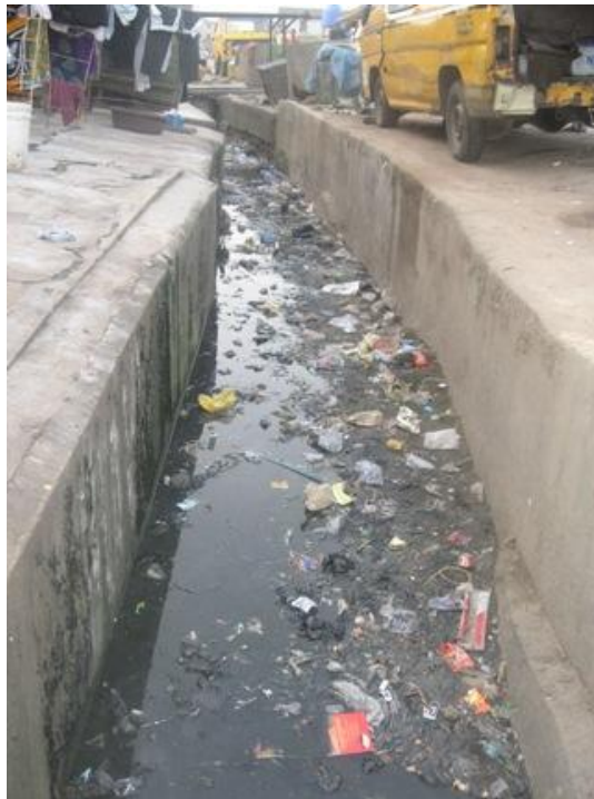
(Abwasserkanal in Lagos)
