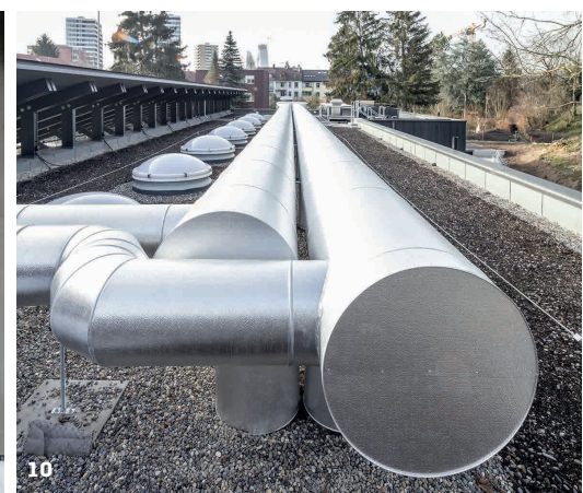
Dachlandschaft mit Lüftungsleitungen
