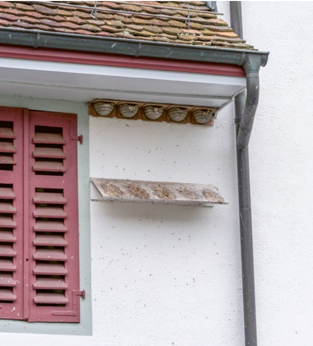
Kotbretter unter Mehlschwalbennestern fangen zuverlässig Kot auf. - Foto: Elena Zihlmann
