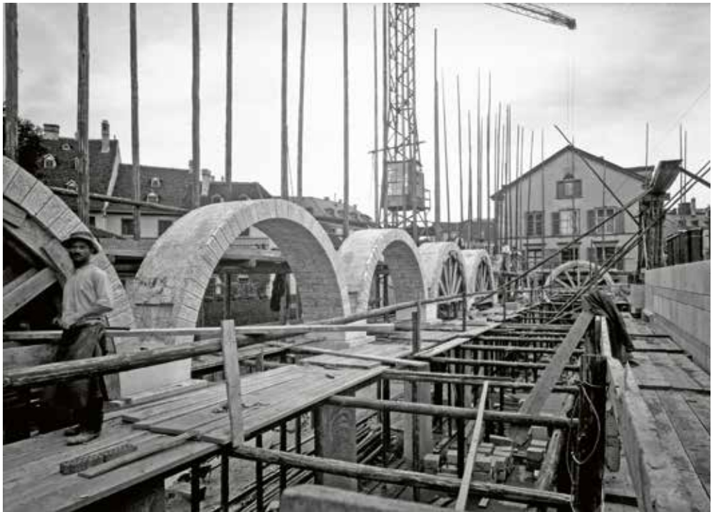
Armierter Bögen der Arkade gegen den St. Alban-Graben, rechts die Fassadenmauer auf gleicher Höhe. Als nächster Bauschritt wurden die Bereiche zwischen und über den Bögen als monolithische Eisenbeton-Konstruktion ausgeführt. Der mächtige Eisenbetonträger über den Bögen wurde so konstruiert, dass er auch beim Ausfall einer der runden Granitstützen der Arkade der Auflast standhält.
