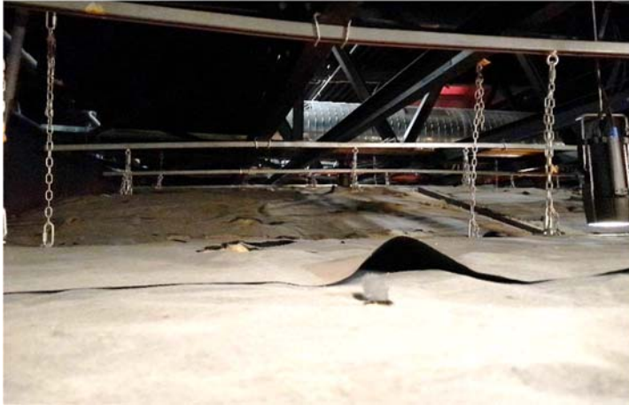
Abbildung 11 - Aufsicht auf die Deckenelemente - die Abdeckungen (Rieselschutz) der Glaswolleinlagen sind teilweise beschädigt
