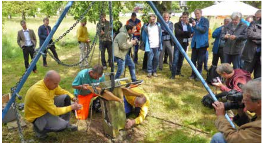
Instandsetzung Landesgrenzstein Nr. 44.
