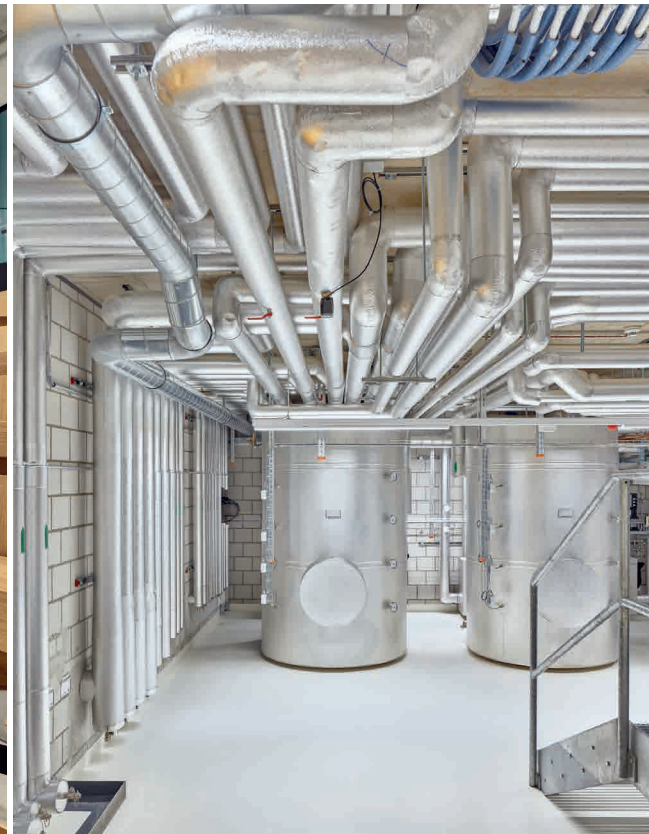
Sanitärzentrale: Boiler zur Warmwasseraufbereitung
