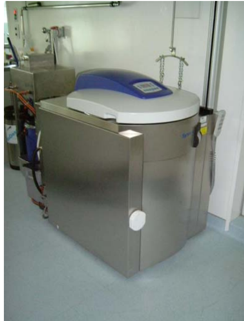
Autoklav zur thermischen Inaktivierung infektiösen Materials
