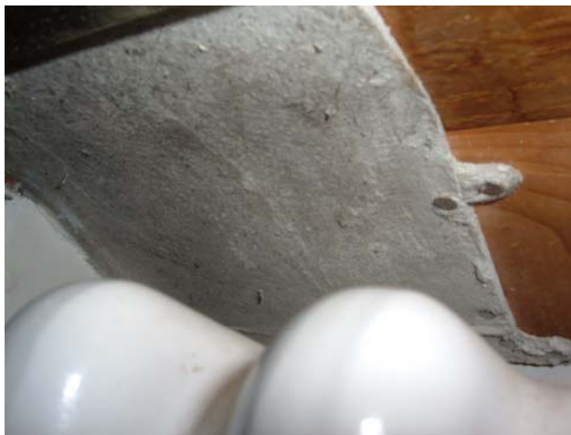
Abb. 1: Asbestkarton unter dem Fenstersims
