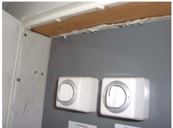
Abb. 2: Isolation im Elektrokasten
