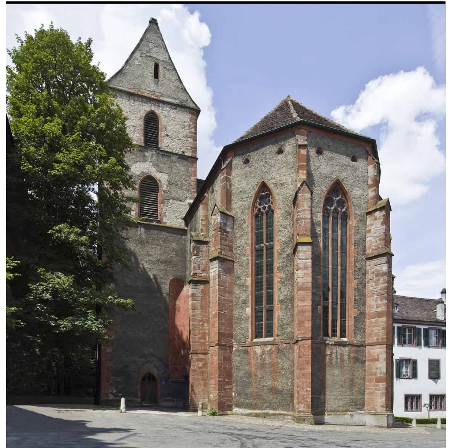
Der Chor der St. Alban-Kirche vor Beginn der Restaurierung. Der hochgotische Chor blieb bei den Veränderungen Mitte des 19. Jahrhunderts unverändert. Aufnahme 2009.
