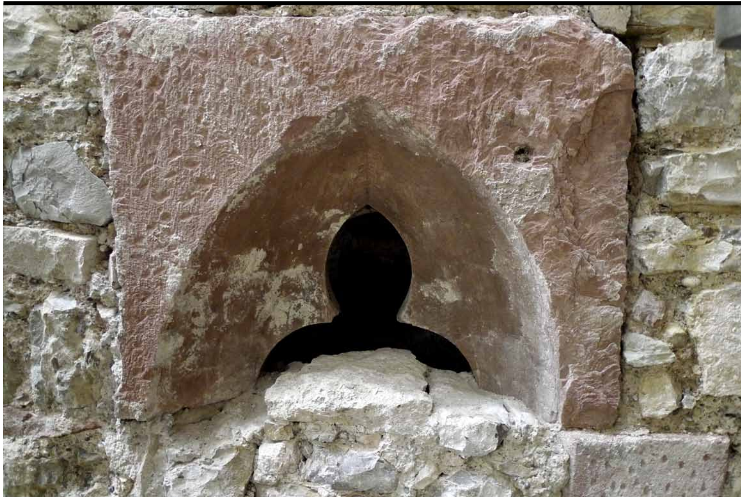
An der Südfassade kam bei der Entfernung des Verputzes von 1911 überraschend ein vermauertes Lanzettfenster zum Vorschein, das aus dem 12. oder frühen 13. Jahrhundert stammt. Diese Mauer hat dem Erdbeben von 1356 standgehalten. Aufnahme Juli 2012.
