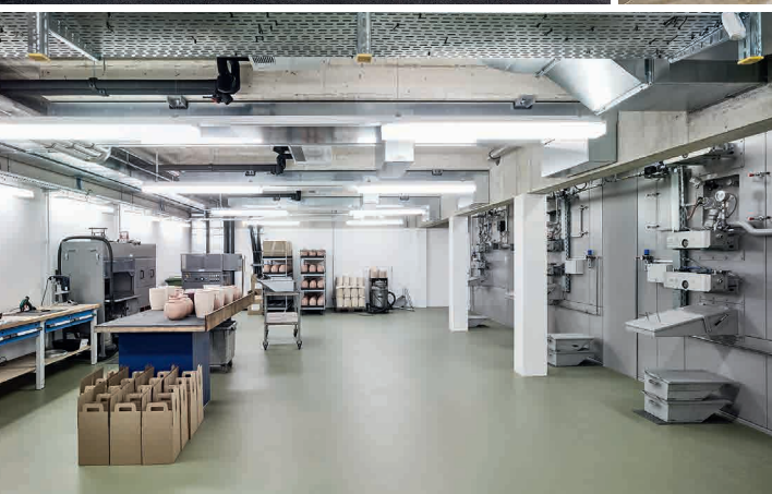
Arbeitsraum mit Ascheentnahme im 1. Untergeschoss
