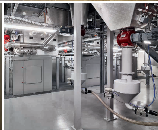
Ofenanlage im 2. Untergeschoss
