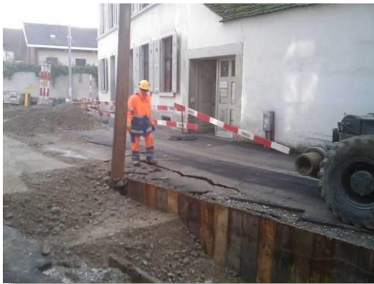
Werkleitungsraben: Spriessung zu spät gezogen
