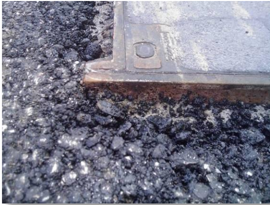
Tragschicht zu hoch gebaut
