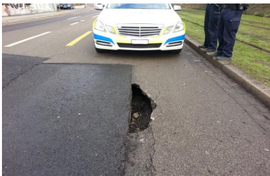
Einbruch bei Bauprovisorium
