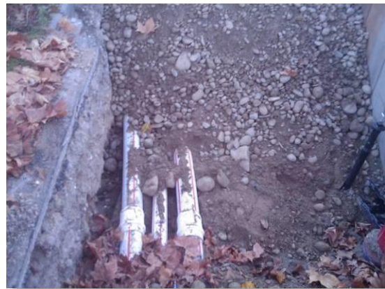
Rohrumhüllung ungenügend (zu grosse Steine)
