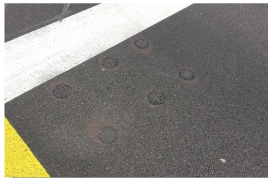
6 Bohrkernbeisammen, anstatt auf 200 m verteilt
