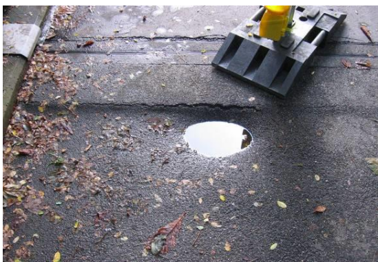
Senkung (ungenügende Verdichtung)
