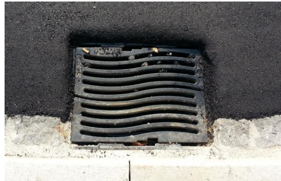
Zu tief eingebauter Einlaufrost
