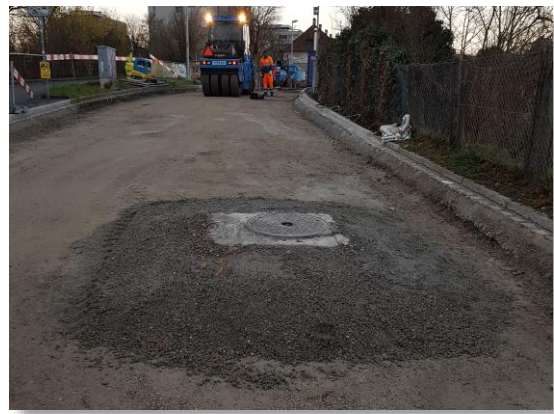
Unzulässige Schachtumhüllung mit Beton
