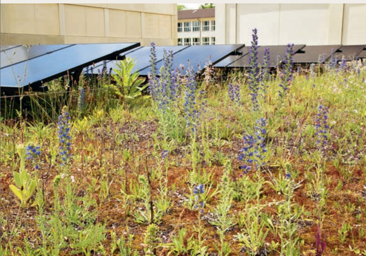
3-jährige Flachdachbegrünung kombiniert mit Solaranlage
