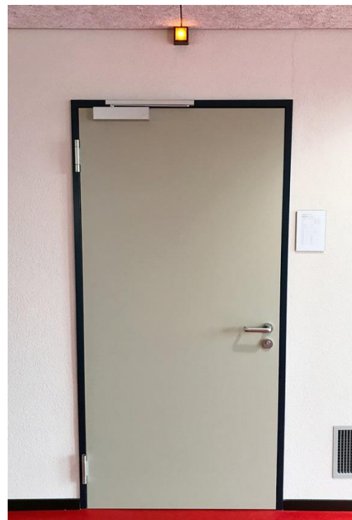
Gelbe Kontrollleuchte Eingang (Gas)
