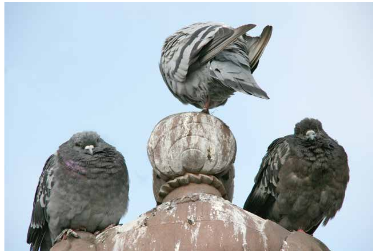
Abbildung 7 Taubenkot führt zu unansehnlichen Verschmutzungen. Wasserlösliche Bestandteile des Taubenkots werden mit dem Regen jeweils abgewaschen, während die schwer wasserlösliche Harnsäure zurückbleibt und schwierig zu entfernende Beläge verursacht. Harnsäure lässt Mikroorganismen wuchern, deren Stoffwechselprodukte Stein zerstören können.
