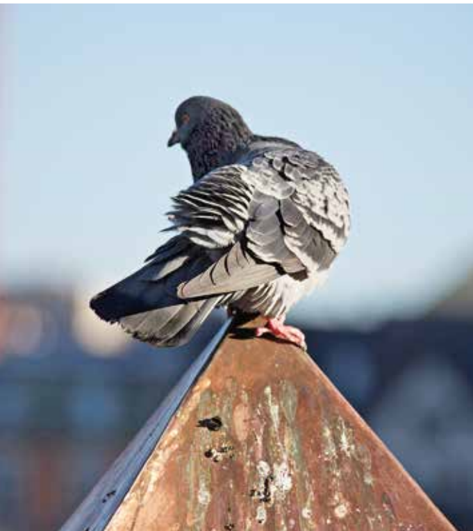
Abbildung 9 Kupfer reagiert besonders empfindlich auf Taubenkot. Schon nach kurzer Zeit entstehen schwer zu entfernende Korrosionsschichten.
