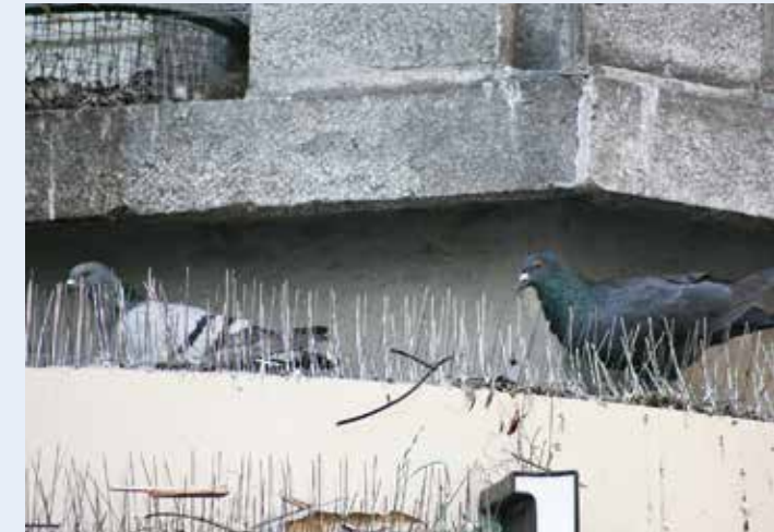
Abbildung 10 Trotz eines Taubenabwehrsystems konnten sich auf den Simsens einer Hausfassade einige Taubenpaare ansiedeln. Das nicht fachmännisch angebrachte Abwehrsystem bot den Tauben sogar zusätzlichen Schutz. Während eines kalten Winters gefror der Taubenkot. Beim Auftauen floss die Taubengülle in die darunter liegende Parfümerie.
