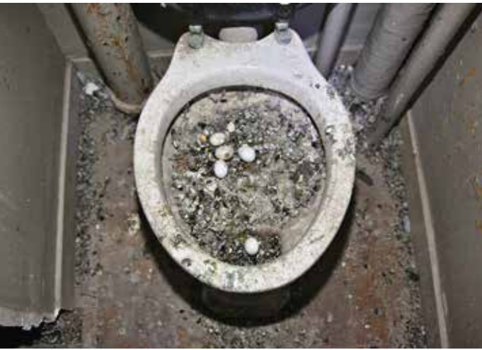
Abbildung 8 Leer stehende Gebäude bieten Strassentauben ideale Brutplätze. Dabei können sich grosse Mengen an Taubenkot ansammeln. In diesem Beispiel wählte ein Taubenpaar eine Toilettenschüssel als Nistgelegenheit.
