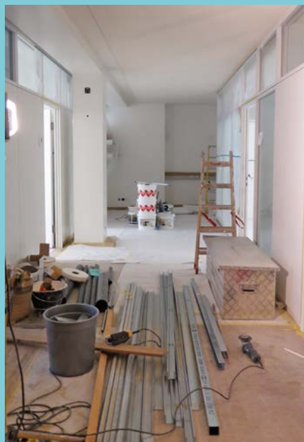
Die Räumlichkeiten an der Schneidergasse 7 im Umbau. Als Orientierungshilfe im Flur werden zum Abschluss die Türrahmen und -klinken dunkel markiert
